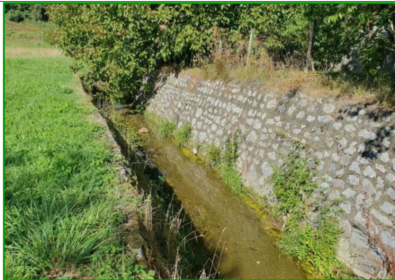
Slika 21. Potok Čučerska Reka – stacionaža km 0 + 510,00 – postojeća obloga korita (Izvor: Tau projekt d.o.o.)
