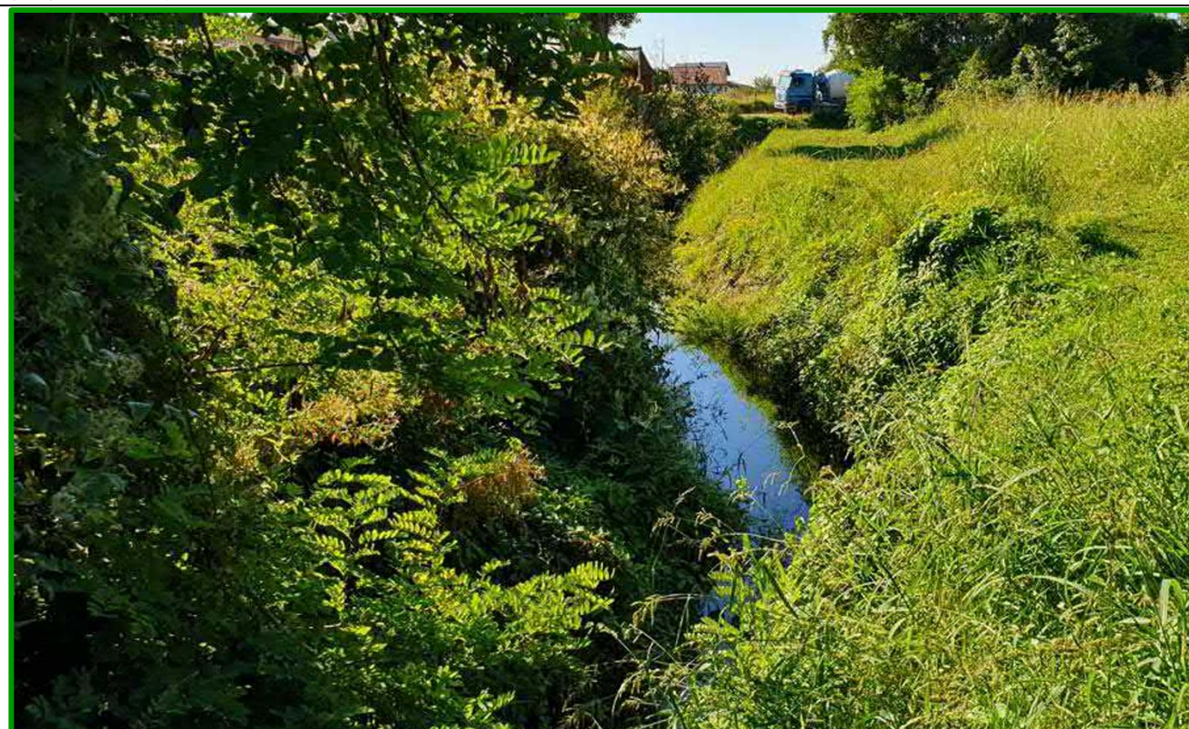
Slika 5. Potok Čučerska Reka – stacionaža oko km 0 +128,00 – 0 + 170,00 - erozija desne obale potoka (Izvor: Tau projekt d.o.o.)
